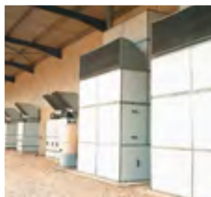
Ventilation répondant aux normes sanitaires et environnementales
