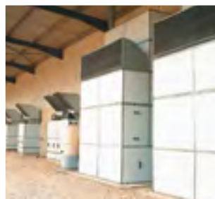
Ventilation répondant aux normes sanitaires et environnementales
