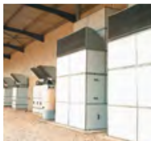
Ventilation répondant aux normes sanitaires et environnementales
