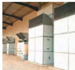
Ventilation répondant aux normes sanitaires et environnementales
