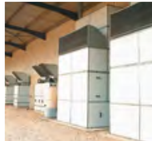
Ventilation répondant aux normes sanitaires et environnementales
